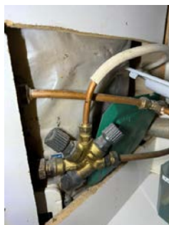
Varmtvannsbereder under benkeskap på kjøkken
