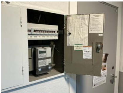
! TO 0 Utstyr for varsling og slukking av brann
