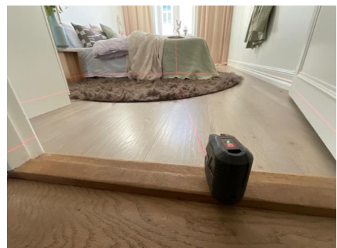
Nivellering soverom, avvik ca. 15-30 mm
