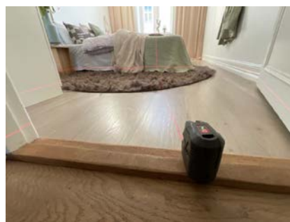
Nivellering soverom, avvik ca. 15-30 mm
