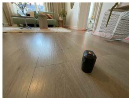
Nivellering stue, soverom, avvik ca. 10-20 mm
