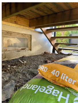
Bildet viser et kjellervindu med råteskade.
