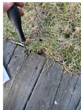
Bildet viser terrassebord med råteskader på terrassen i underetasjen.
