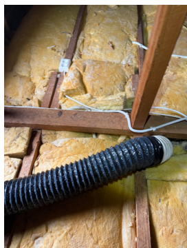
Bildet viser en kabel som ikke er tilstrekkelig festet.
