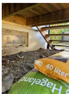
Bildet viser et kjellervindu med råteskade.
