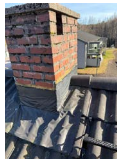
Bildet viser beslag rundt pipen hvor det er påvist svakheter i utførelsen.
