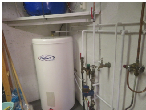
Bilde av beredere til varmtvann og vannbåren varme.
