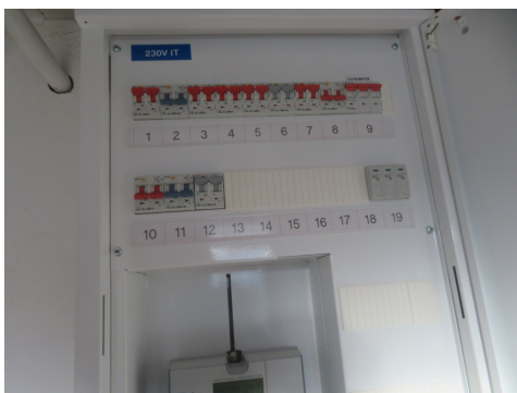
Sikringsskap i gammel del
