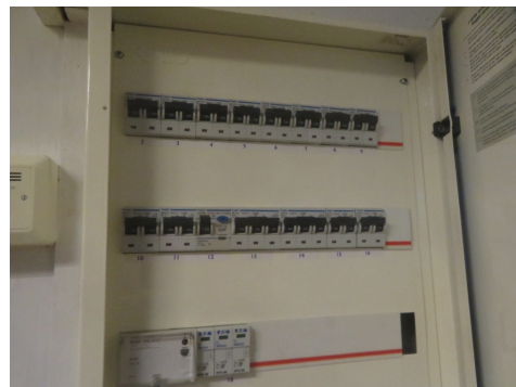
Sikringsskap i ny del.
