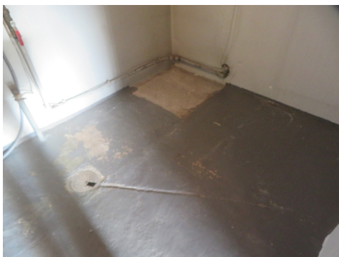
Vannledning i gammel del.
