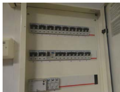
Sikringsskap i ny del.
