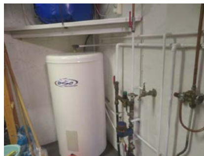
Vanninntak i ny del.
