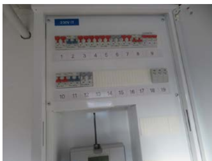
Sikringsskap i gammel del
