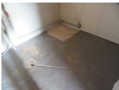
Vannledning i gammel del.
