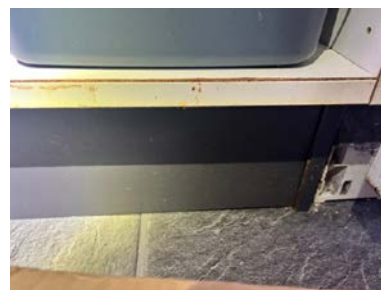
Fuktsvelling på benkeskap
