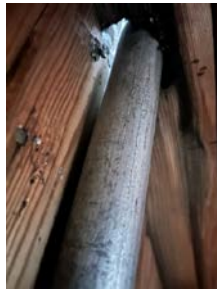
Åpning rundt rørgjennomføring i taket.
