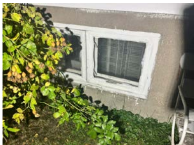
Ytre glass mangler, skader på glassramme
