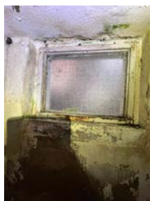
Vindu utvendig trappe nedgang, dårlig stand
