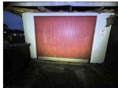
Råte på garasjeport.
