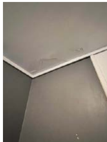
Skade på himling soverom 2 etasje
