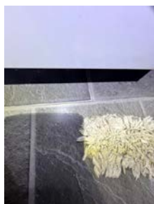
Noe fuktsvelling på gulvet ved oppvaskmaskin.
