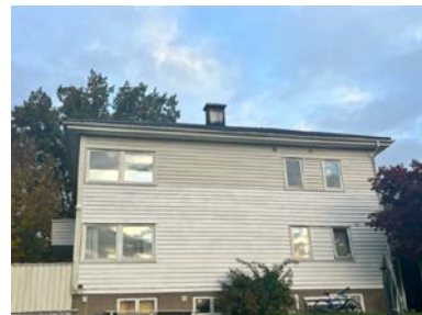
Vegg er ikke ferdig malt.
