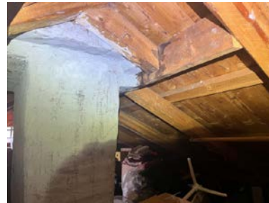
Eldre fuktmerker ved pipe
