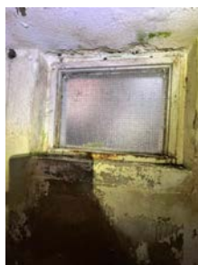
Vindu utvendig trappe nedgang, dårlig stand
