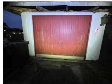
Råte på garasjeport.
