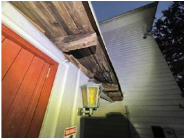
Råteskader i bordtro
