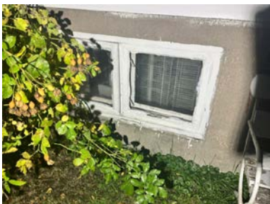
Ytre glass mangler, skader på glassramme
