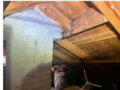
Eldre fuktmerker ved pipe
