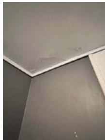
Skade på himling soverom 2 etasje
