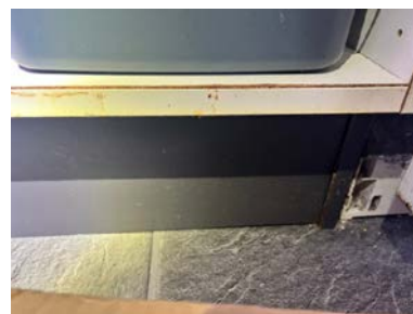
Fuktsvelling på benkeskap
