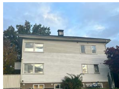
Vegg er ikke ferdig malt.
