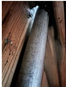
Åpning rundt rørgjennomføring i taket.
