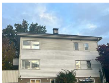
Vegg er ikke ferdig malt.
