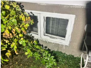
Ytre glass mangler, skader på glassramme
