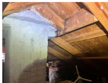
Eldre fuktmerker ved pipe
