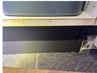
Fuktsvelling på benkeskap
