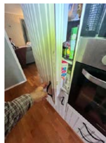
Slitasje merker på dør til kjøleskap
