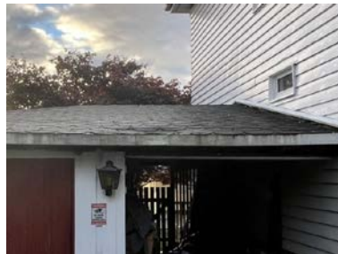
Skade på tekking på grunn av råteskader i bordtro
