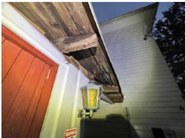
Råteskader i bordtro
