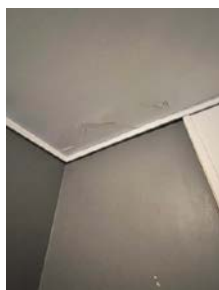
Skade på himling soverom 2 etasje
