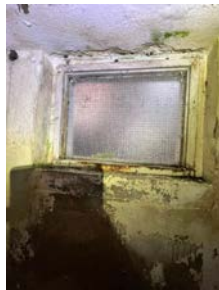
Vindu utvendig trappe nedgang, dårlig stand
