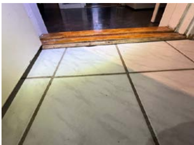
lav oppkant under dør og skade på flis
