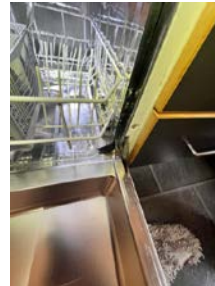
Dør på oppvaskmaskin er ikke helt tett
