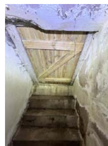
Lem på kjellerinnang, det kommer inn litt vann
