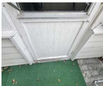
Balkongdør 2 etasje, behov for utvendig behandling og bytte av pakninger.
