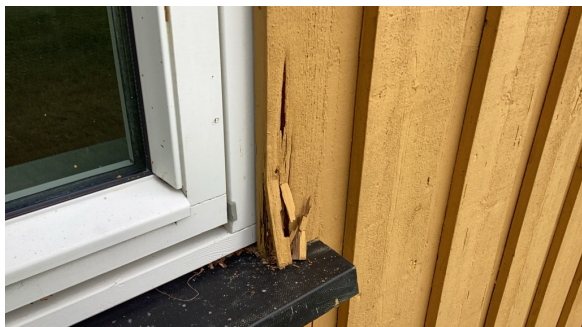
Eksempel på råte i kledning.
