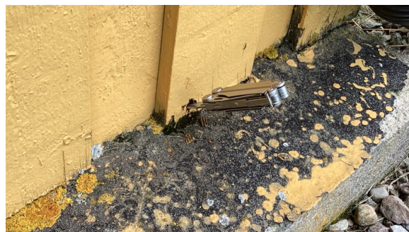
Eksempel på råte i kledning.
