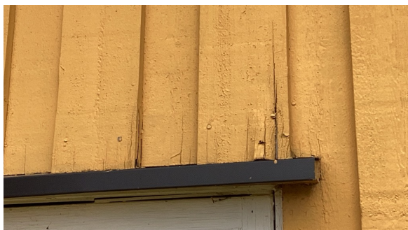
Eksempel på råte i kledning.
