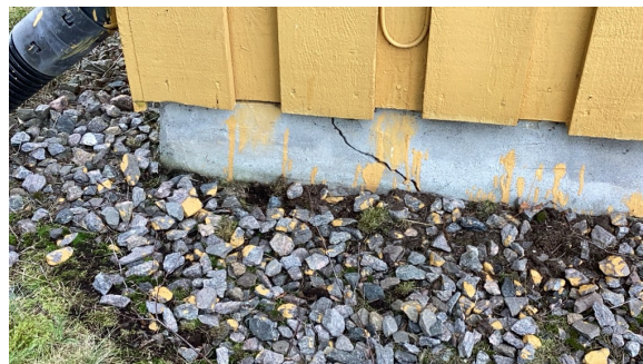
Eksempel på sprekk i grunnmur.
