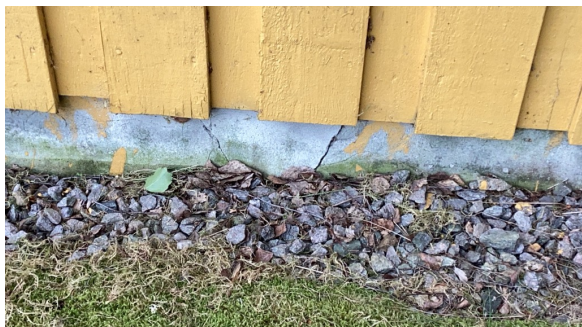
Eksempel på sprekk i grunnmur.
