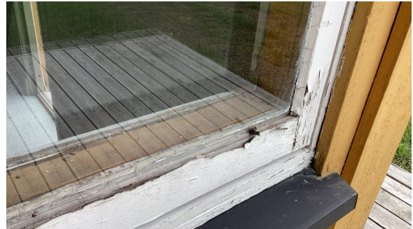
Eksempel på slitasje og avskaling av kitt.
