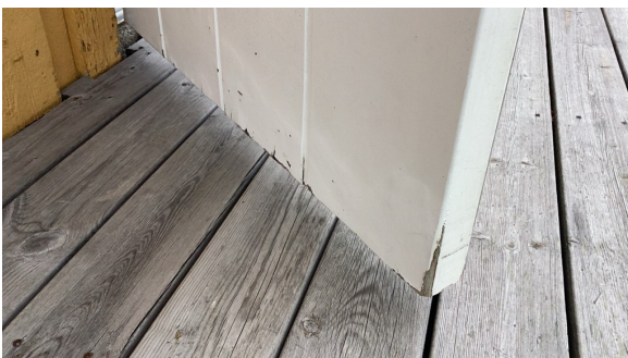
Fukt- og svelleskade nederst på dør.
