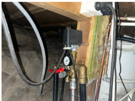
Stoppekran under kjøkken.
