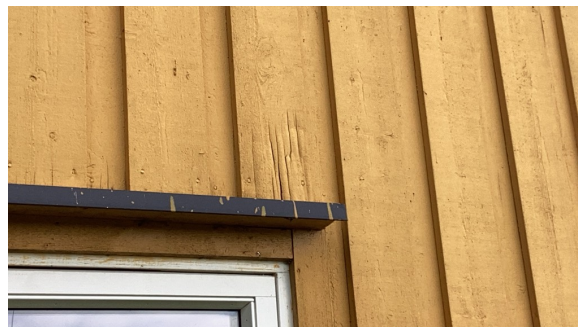
Eksempel på råte i kledning.
