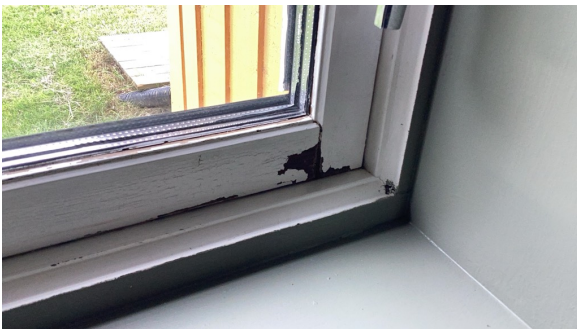
Eksempel på innvendig slitasje.
