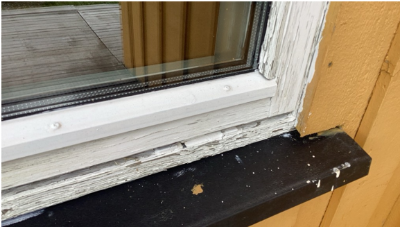
Eksempel på slitasje.
