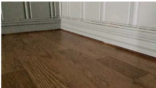
Det er glipper mellom gulv og gulvlist.
