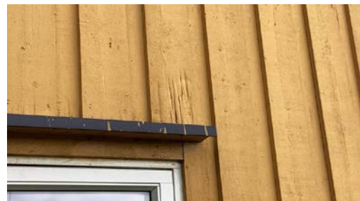
Eksempel på råte i kledning.
