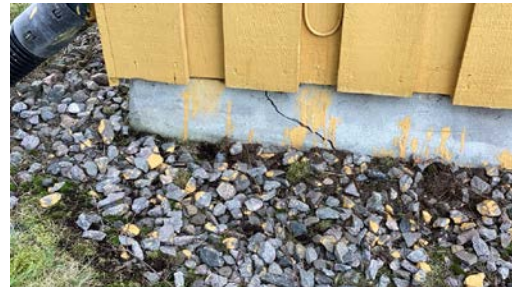
Eksempel på sprekk i grunnmur.
