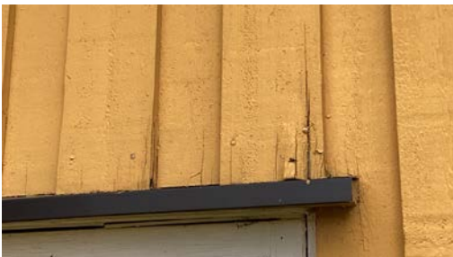
Eksempel på råte i kledning.
