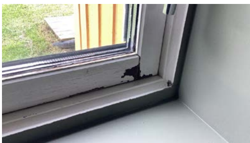
Eksempel på innvendig slitasje.
