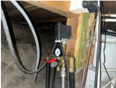
Stoppekran under kjøkken.
