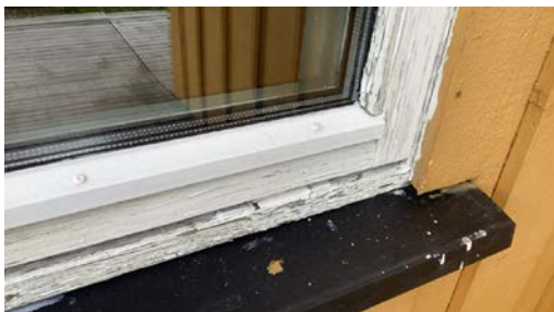
Eksempel på slitasje.
