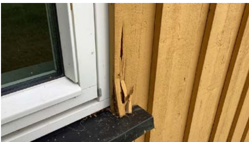
Eksempel på råte i kledning.
