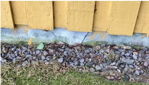
Eksempel på sprekk i grunnmur.
