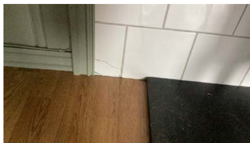
Sprekk i flis i stue.
