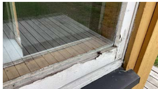
Eksempel på slitasje og avskaling av kitt.
