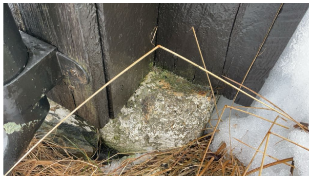
Råte i kledning/yttervegg, utsatt for fuktpåkjenning
