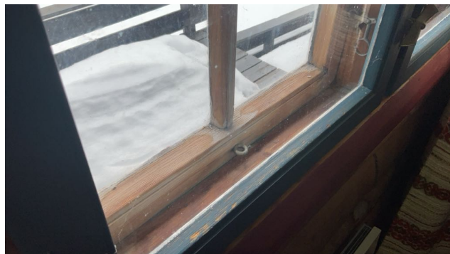
Vinduer er preget av elde og slitasje
