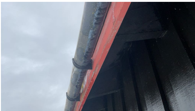
Slitasje på renner med punkt lekkasje
