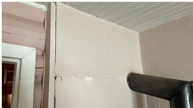
Sprekker i brannmur ved røykrør fra soverom
