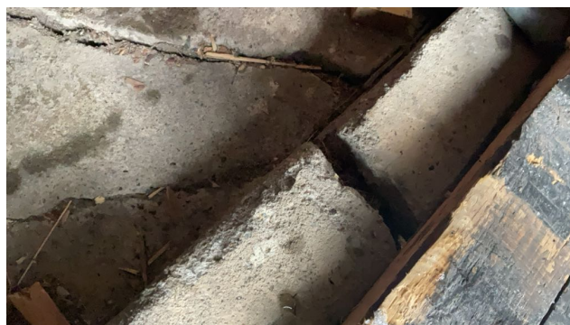
Sorekk med utglifåding registrert fra utvendig bod
