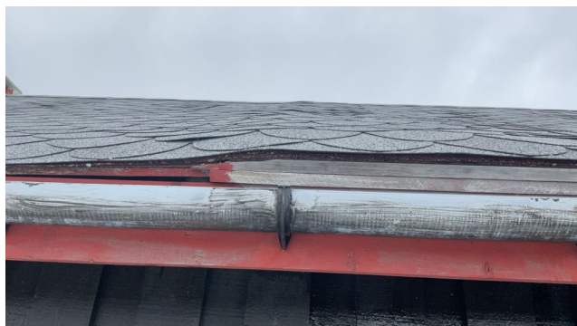
Skjevheter i takkonstruksjon
