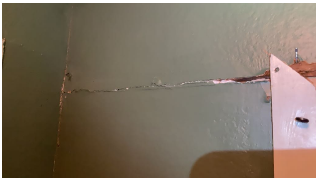
Slitasje/skader på plate
