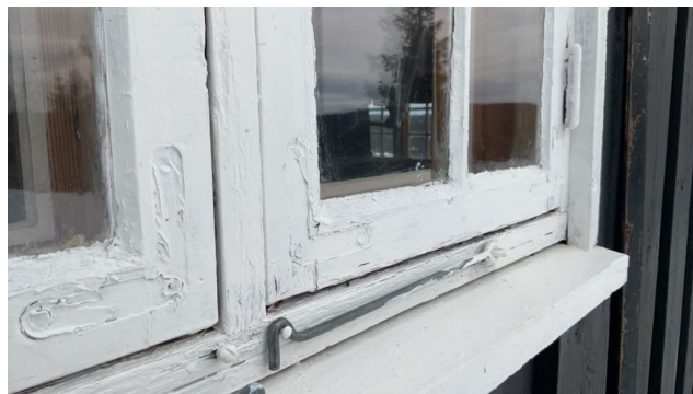
Sorekddannelse i treverk og kitt
