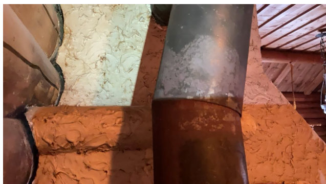
Slitasje og overgang skjøt er ikke egnet på røykrør
