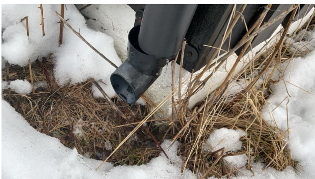
Manglende bortledning av takvann
