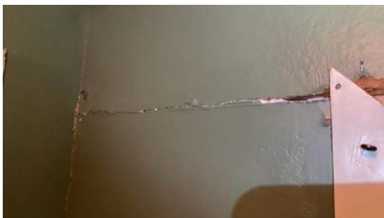
Slitasje/skader på plate
