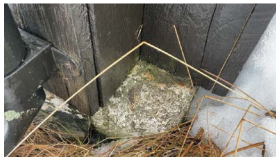
Råte i kledning/yttervegg, utsatt for fuktpåkjønning
