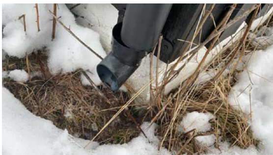
Manglende bortledning av takvann
