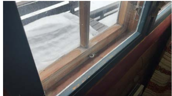
Vinduer er preget av elde og slitasje
