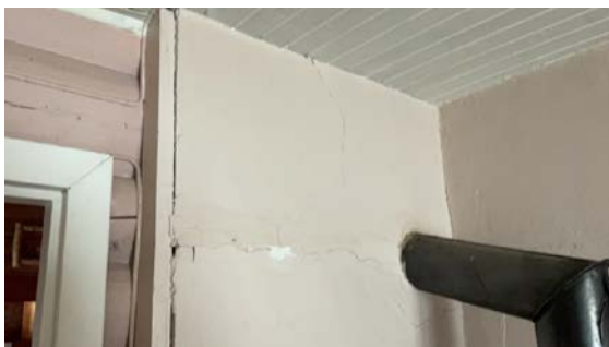
Sprekker i brannmur ved røykrør fra soverom
