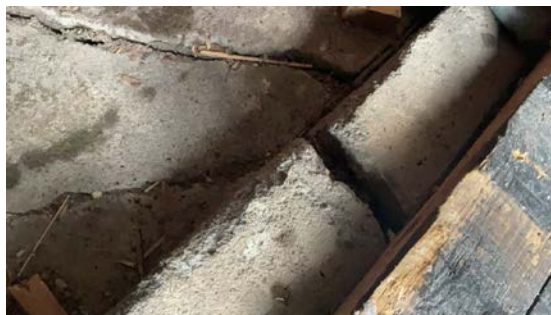
Sorekk med utglifåding registrert fra utvendig bod
