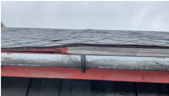
Skjevheter i takkonstruksjon
