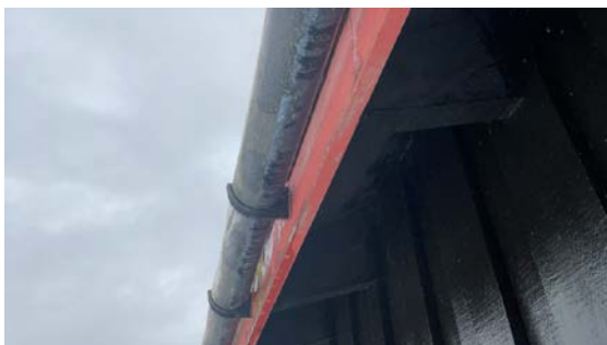
Slitasje på renner med punktlekkasje
