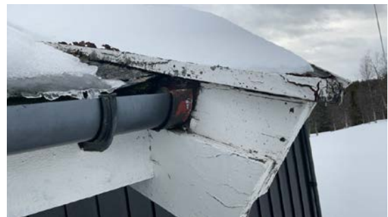
Slitasje med mosedannelse registrert, slitasje på vindskier og isbord
