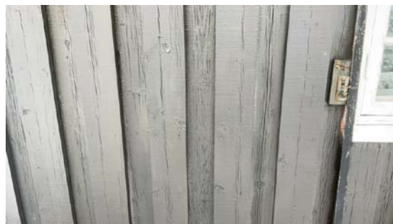
Slitasje og sprekkdannelse i kledningsbord
