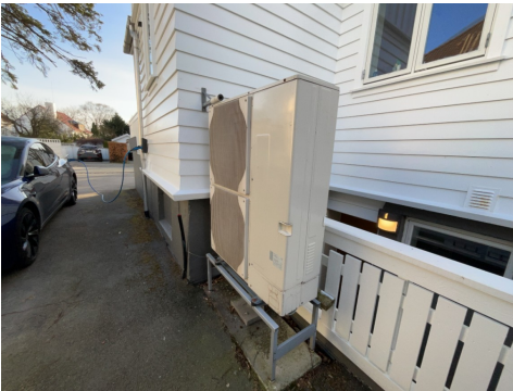
Utedel på varmeanlegget
