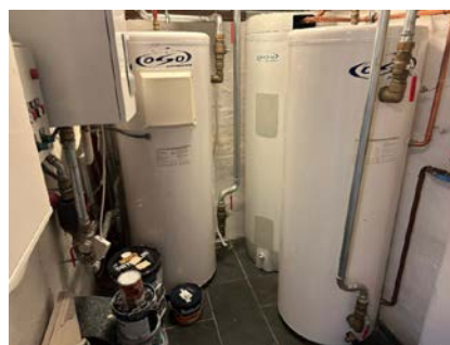
Fellesanlegg for varmtvann og vannbåren varme.
