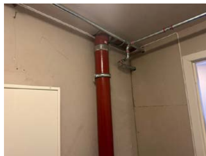
Nyere støpejernsrør er synlige i kjeller.
