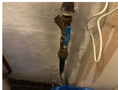
Hovedstoppekran er plassert i teknisk rom i kjeller.
