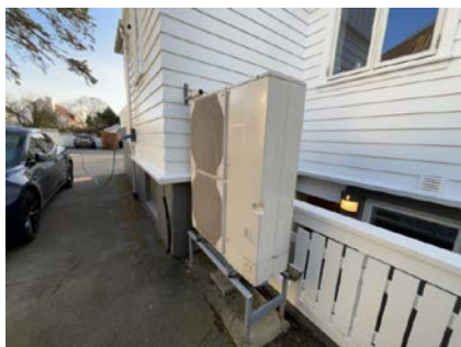
Utedel på varmeanlegget
