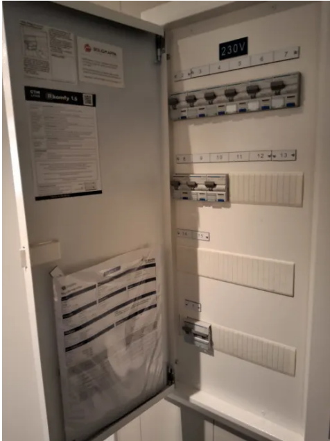
Sikringsskap med automatsikringer er plassert i gang.
