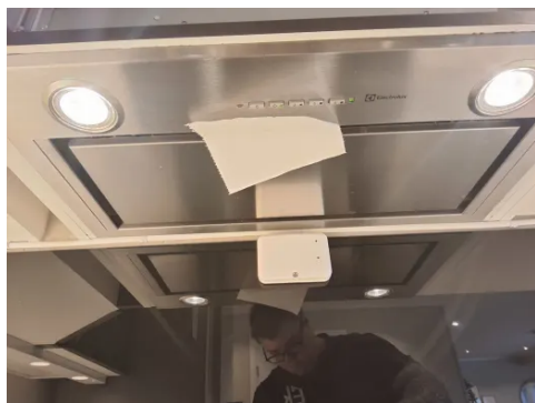
Avtrekkseffekt er testet med papir.
