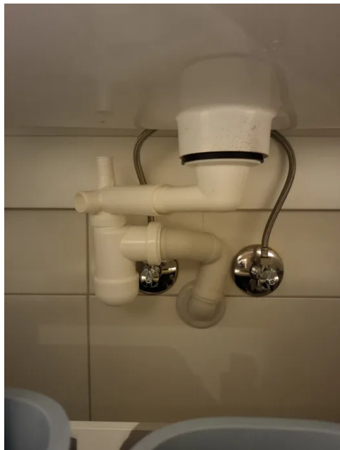
Leiligheten har synlige avløpsrør av plast.
