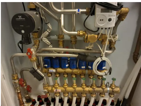
Rørapplegg til vannbåren gulvvarme.
