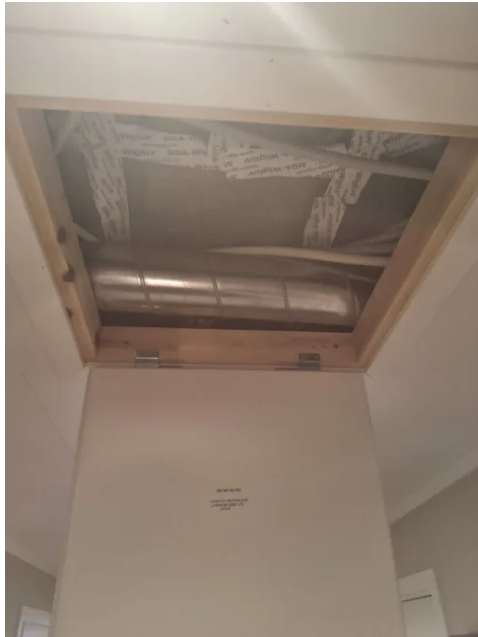
Inspeksjonsluke er plassert i gang.
