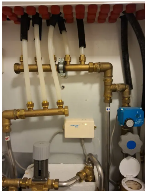
Rørfordeling og hovedstoppekrane er plassert i skap på bod/teknisk rom.
