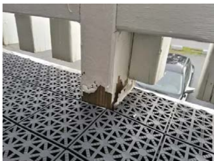
Stedvis avflasset maling på rekkverk.
