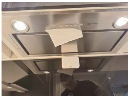
Avtrekkseffekt er testet med papir.
