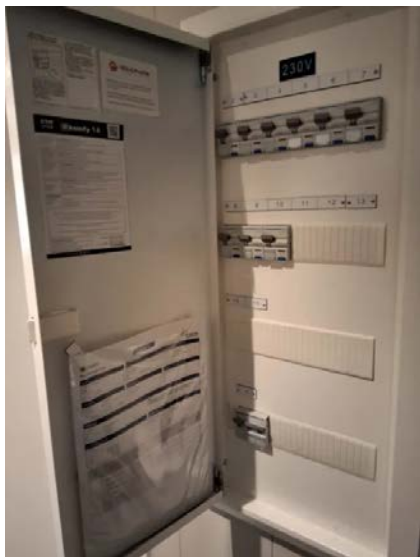
Sikringsskap med automatsikringer er plassert i gang.
