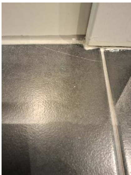
Sprukket gulvflis ved dør.
