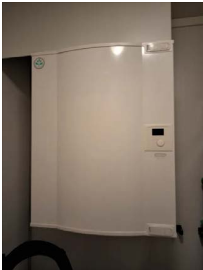
Ventilasjonsaggregat er plassert i bod/teknisk rom.
