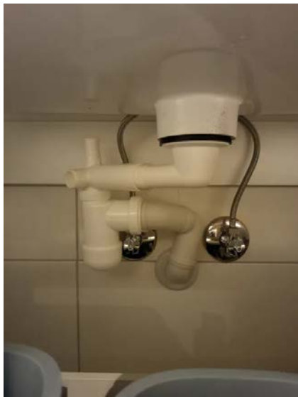
Leiligheten har synlige avløpsrør av plast.
