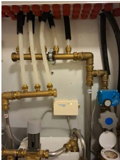
Rørfordeling og hovedstoppekran er plassert i skap på bod/teknisk rom.
