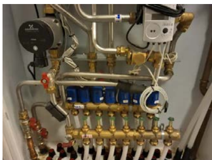
Rørapplegg til vannbåren gulvvarme.
