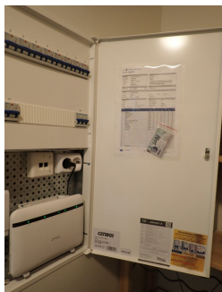
Sikringsskap med automatsikringer, dokumentasjon og kursfortegnelse.
