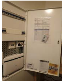
Sikringsskap med automatsikringer, dokumentasjon og kursfortegnelse.
