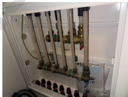
Samleskap for vannrør på bad
