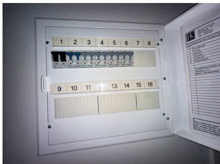
Sikringsskap med automatsikringer.
