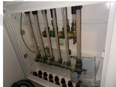
Samleskap for vannrør på bad
