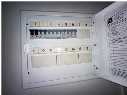
Sikringsskap med automatsikringer.
