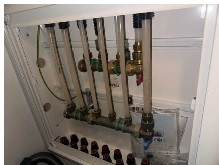
Samleskap for vannrør på bad
