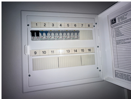
Sikringsskap med automatsikringer.
