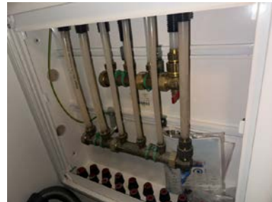
Samleskap for vannrør på bad
