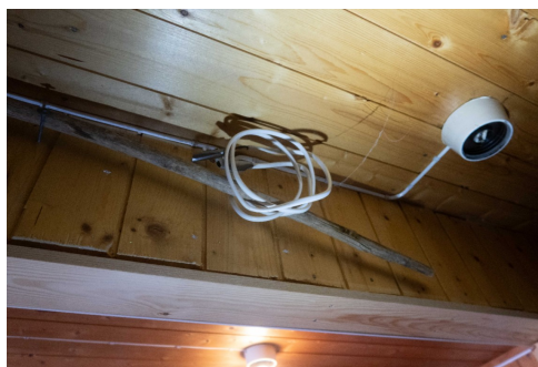
Bilder av løse ledninger i entré/ gang
