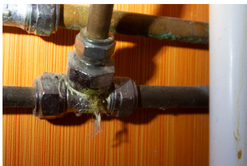
Bilde viser irr-dannelse på kobberør
