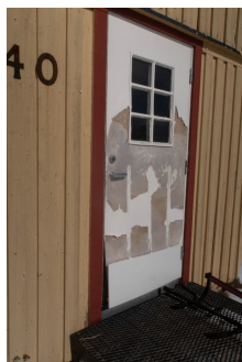
Bilde viser skadet ytterdør mot sør
