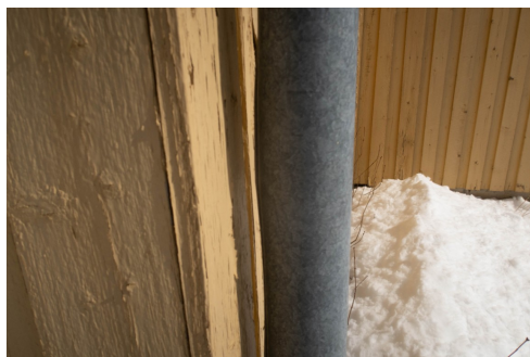
Bilde viser eksempel på frostsprengt nedløpsrør
