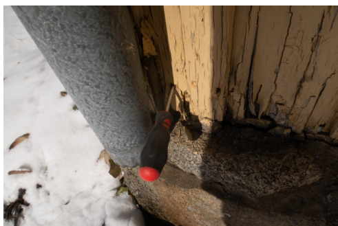
Bilde viser eksempel på råteskade i ytterkledning
