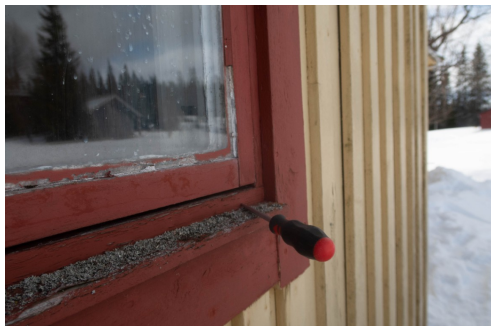
Bilde viser råteskade i vindu på bad
