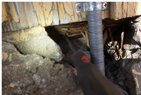
Bilde viser eksempel på råteskade i yttervegg
