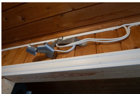
Bilder av løse ledninger i entré/ gang
