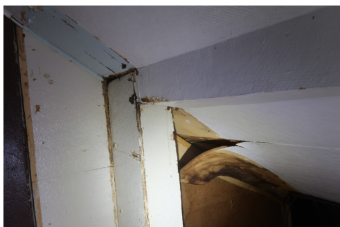
Bilde viser skader etter fuktbelastning i innvendig tak og vegg i 2. etasje
