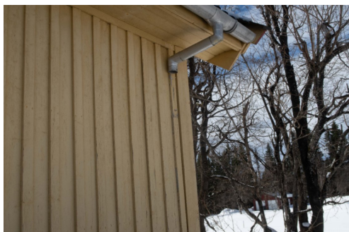
Bilde viser manglende nedløpsrør
