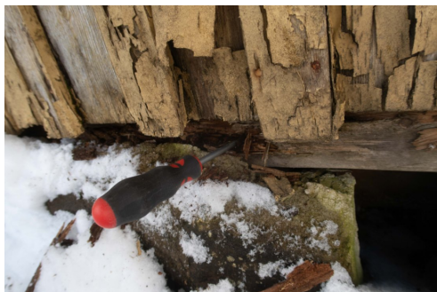
Bilde viser eksempel på råteskade i yttervegg
