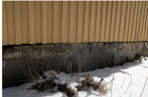
Bilde viser sprekker og setningsskader i grunnmur
