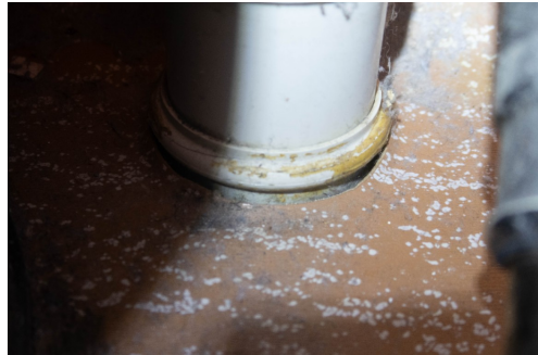
Bilde viser eksempel på utetthet rundt rørgjennomføring
