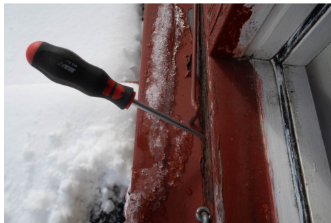
Bilde viser råteskade i vindu i 2. etasje mot øst
