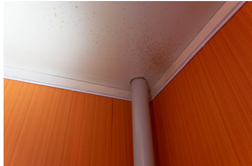
Bilde viser misfarging av takplater
