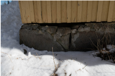
Bilde viser sprekker og setningsskader i grunnmur
