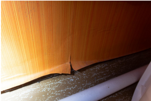
Bilde viser slitasje på veggoverflater
