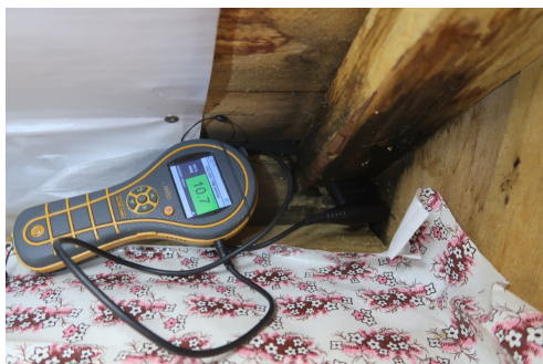
Bilde viser eksempel på fuktskjolder i takkonstruksjon.
