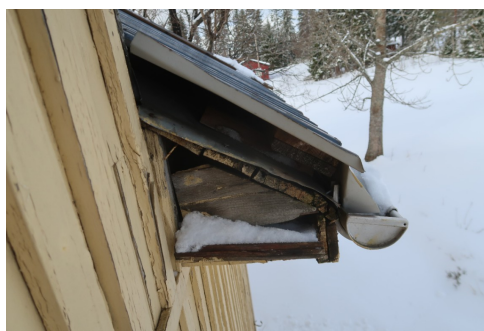
Bilde viser eksempel på manglende vindskie
