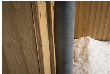
Bilde viser eksempel på frostsprengt nedløpsrør
