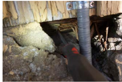
Bilde viser eksempel på råteskade i yttervegg
