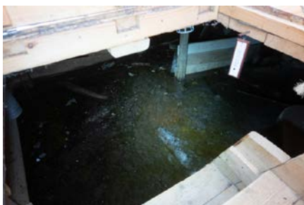
Bilde viser fritt vann i krypekjeller under stue
