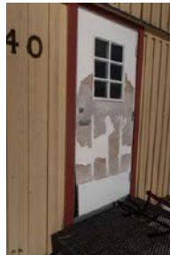
Bilde viser skadet ytterdør mot sør
