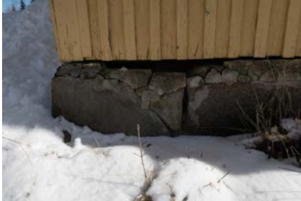
Bilde viser sprekker og setningsskader i grunnmur
