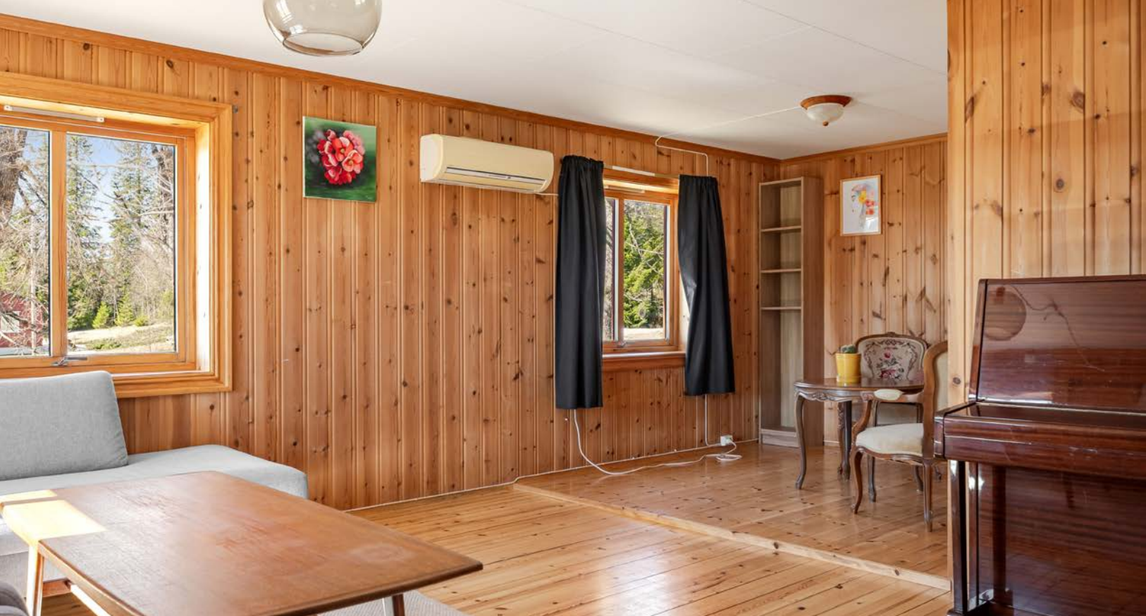
Det er montert luft-til-luft varmepumpe på veggen.
