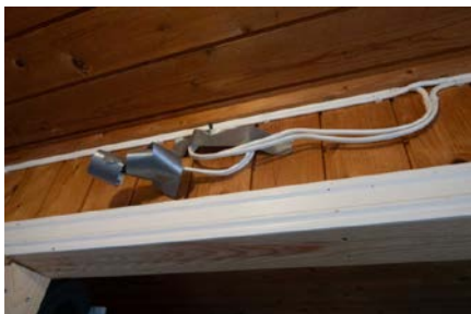
Bilder av løse ledninger i entré/ gang
