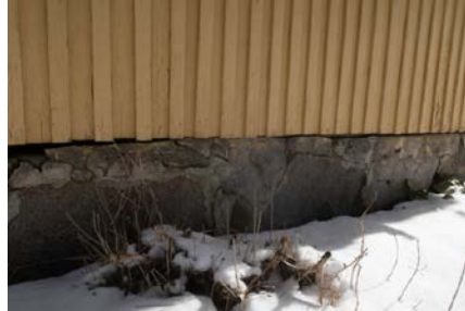
Bilde viser sprekker og setningsskader i grunnmur
