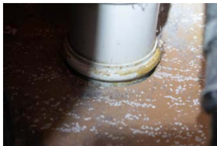
Bilde viser eksempel på utetthet rundt rørgjennomføring
