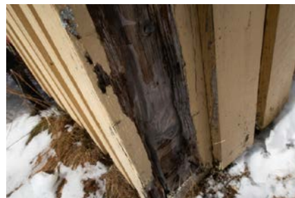
Bilde viser skader på ytterkledning og bruk av plast bak ytterkledning.
