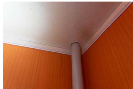
Bilde viser misfarging av takplater
