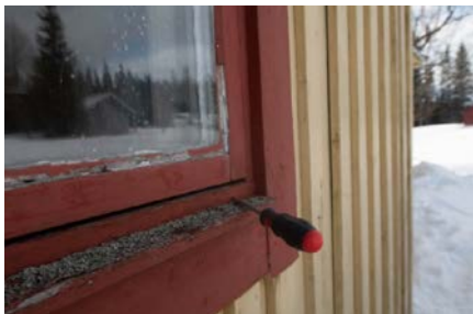
Bilde viser råteskade i vindu på bad
