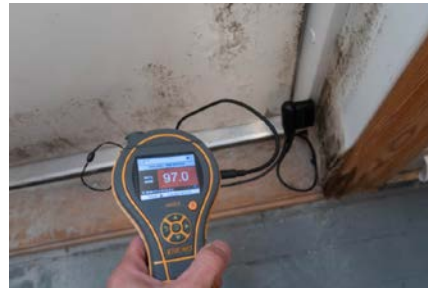
Bilde viser måling av skadelig fukt og muggdannelser på ytterdør mot sør
