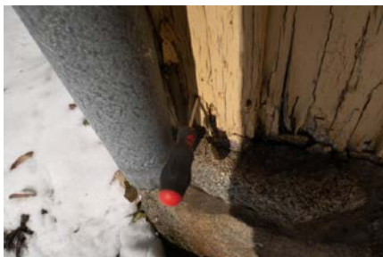
Bilde viser eksempel på råteskade i ytterkledning
