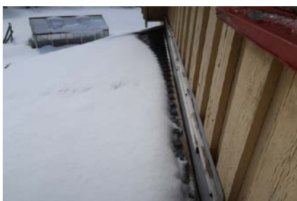
Bilde viser manglende beslag/ avslutning ved overbygget inngangsparti
