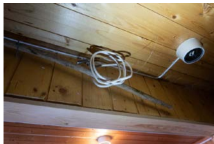
Bilder av løse ledninger i entré/ gang
