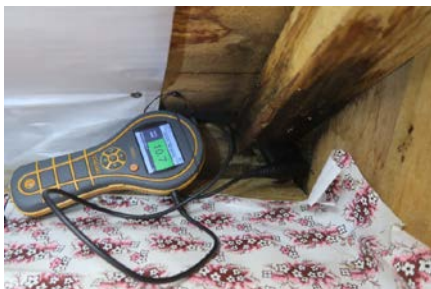
Bilde viser eksempel på fuktskjolder i takkonstruksjon. Ikke skadelig fukt på befaringsdagen.
