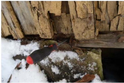
Bilde viser eksempel på råteskade i yttervegg
