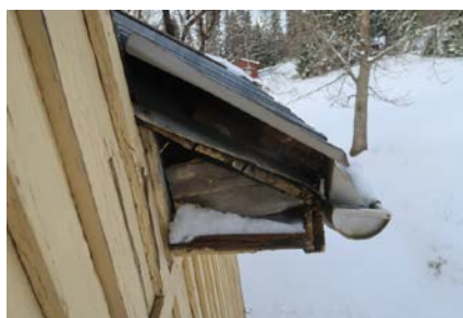
Bilde viser eksempel på manglende vindskie
