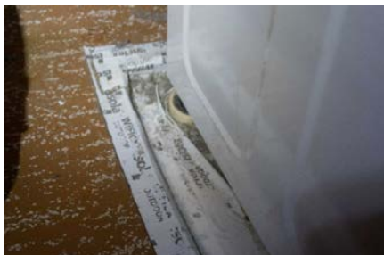
Bilde viser manglende gulvbelegg under vaskemaskin
