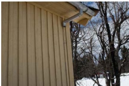
Bilde viser manglende nedløpsrør
