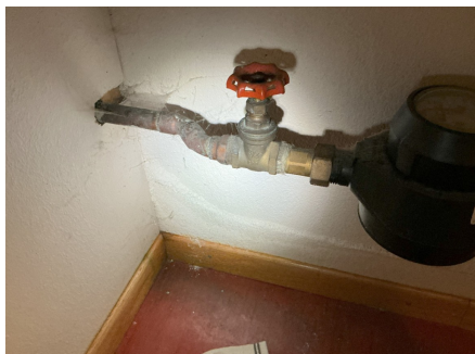
Salt/kalkutslag på vegg
