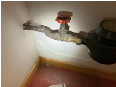
Salt/kalkutslag på vegg
