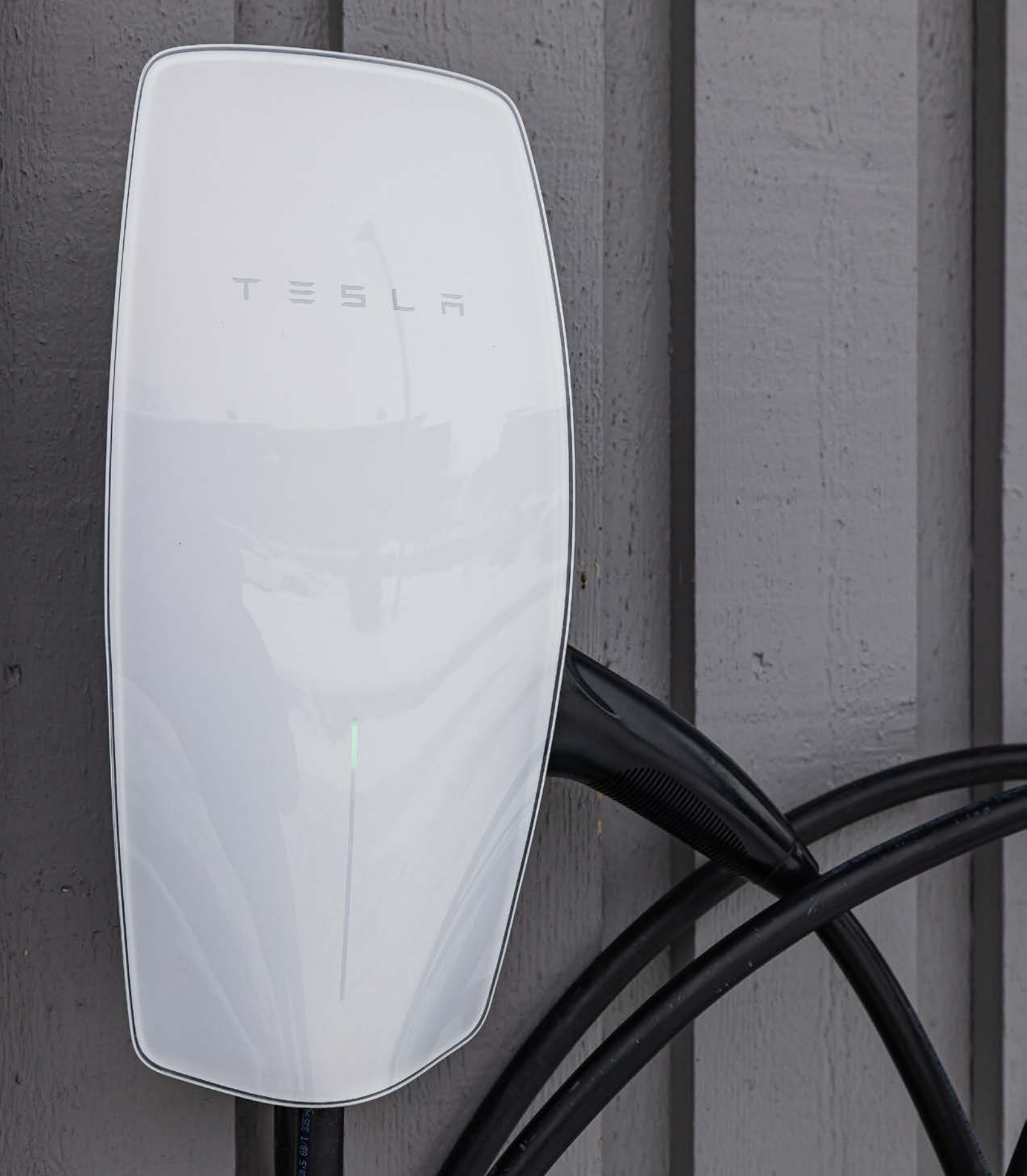
Det er montert elbil-lader fra Tesla på husveggen.
