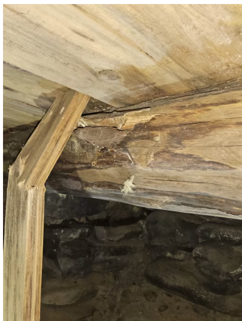
Bilde viser råteskader i etasjeskiller.
