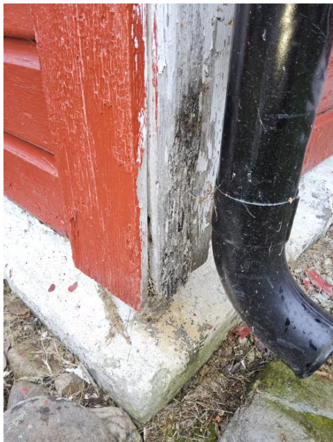
Bilde viser råteskader på fasaden.
