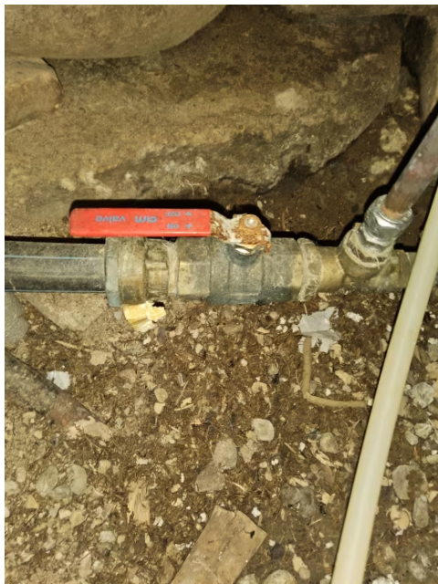
Bilde viser rust på hovedstoppekran.
