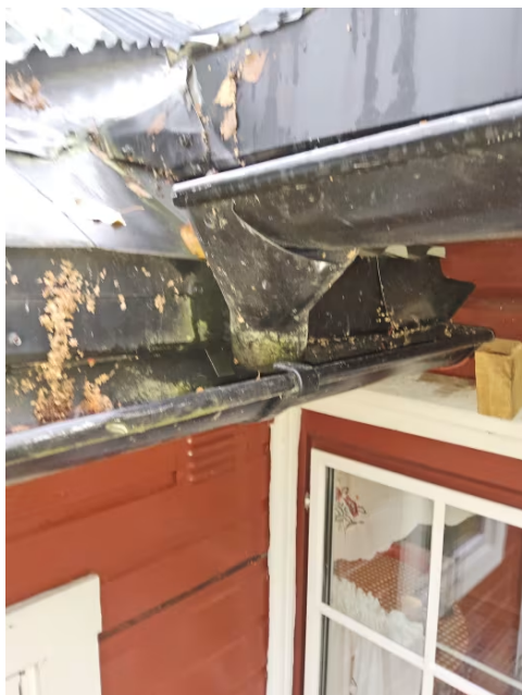
Bilde viser ufagmessig utførelse av renner.
