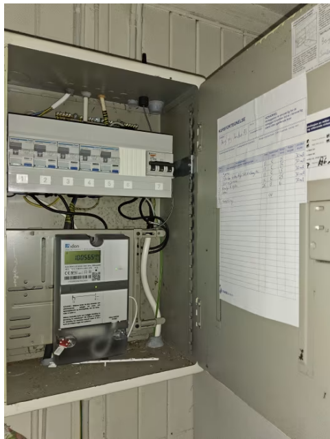
Bilde viser sikringsskap.
