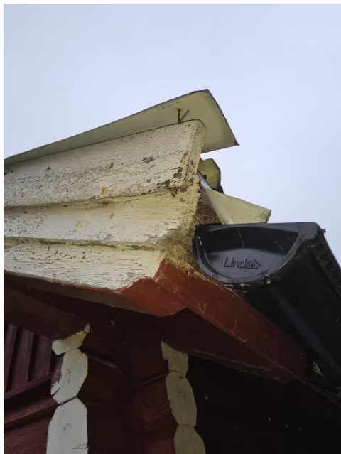
Bilde viser råteskader på fasaden.
