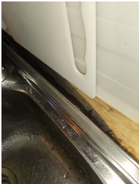
Bilde viser fuktskade rundt oppvaskkum.
