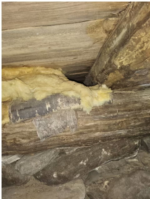
Bilde viser mangelfull og ufagmessig isolering.
