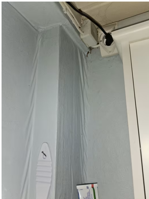
Bilde viser høy slitasjegrad på veggflater.
