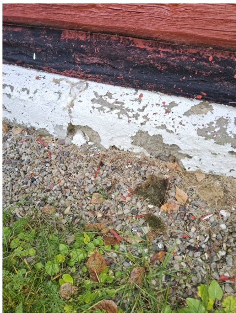
Bildet viser manglende utvendig fuktsperre.
