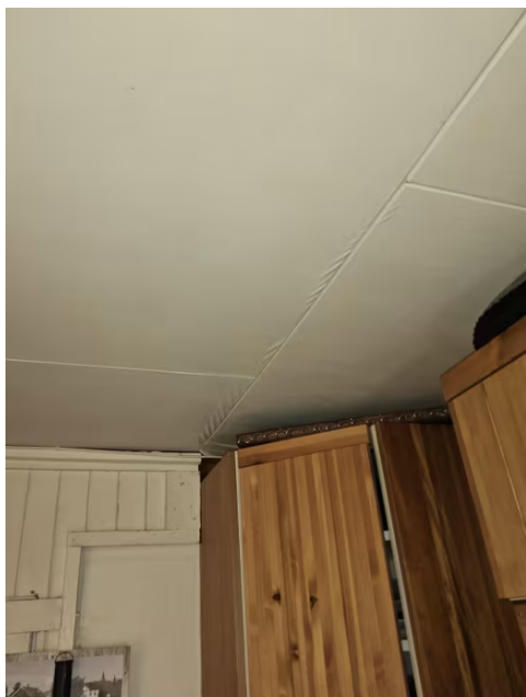
Bilde viser skader i himling.
