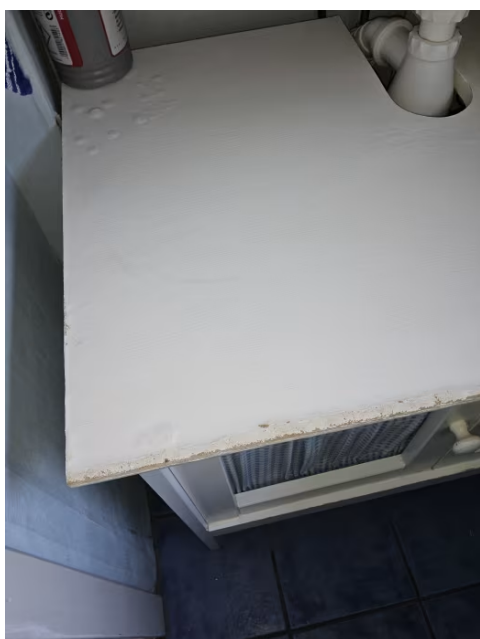
Bilde viser fuktskadet innredning.
