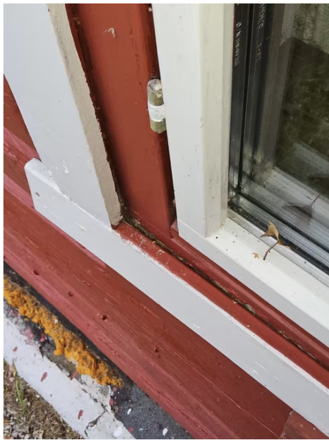
Bilde viser åpninger mellom omramming og vindu.
