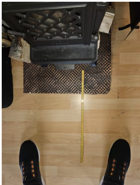
Bilde viser for liten ubrennbar plate.
