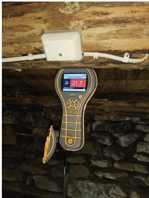
Bilde viser fuktmåling i etasjeskiller.
