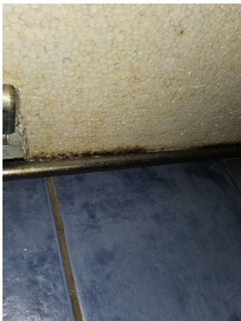
Bilde viser muggsopp på isoporplate på vegg.
