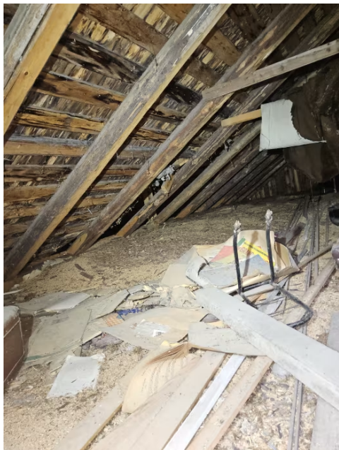
Bilde viser kaldtloft sett fra luke.
