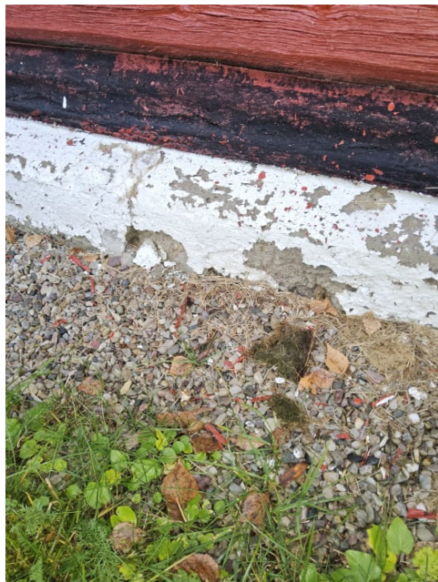
Bilde viser avskalling av grunnmur.
