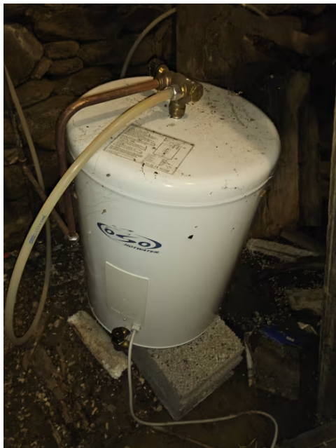
Bilde viser varmtvannsbereder.
