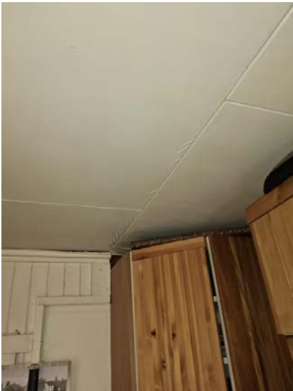
Bilde viser skader i himling.
