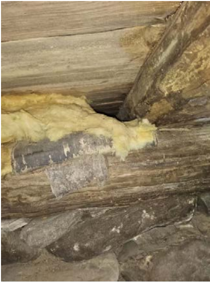
Bilde viser mangelfull og ufagmessig isolering.
