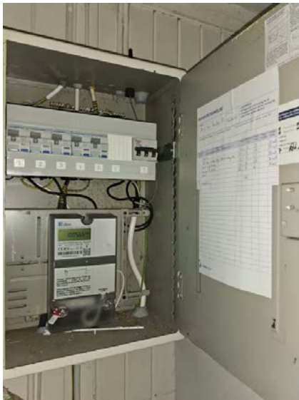
Bilde viser sikringsskap.
