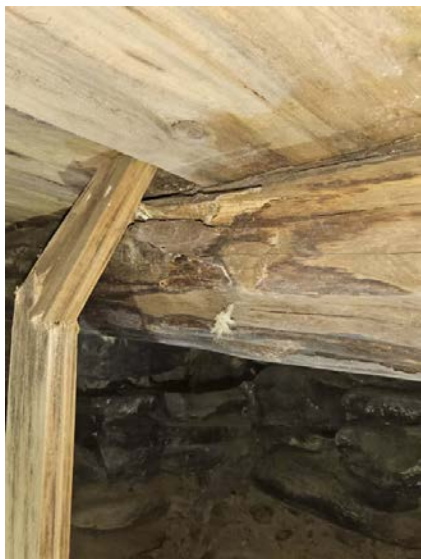
Bilde viser råteskader i etasjeskiller.
