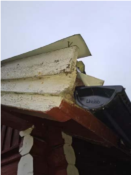
Bilde viser råteskader på fasaden.
