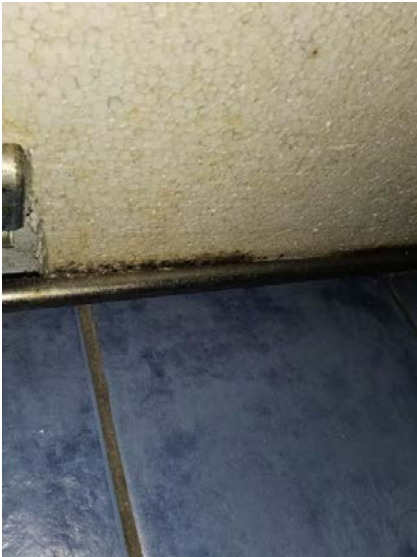
Bilde viser muggsopp på isoporplate på vegg.
