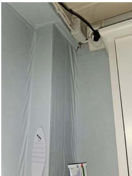
Bilde viser høy slitasjegrad på veggflater.
