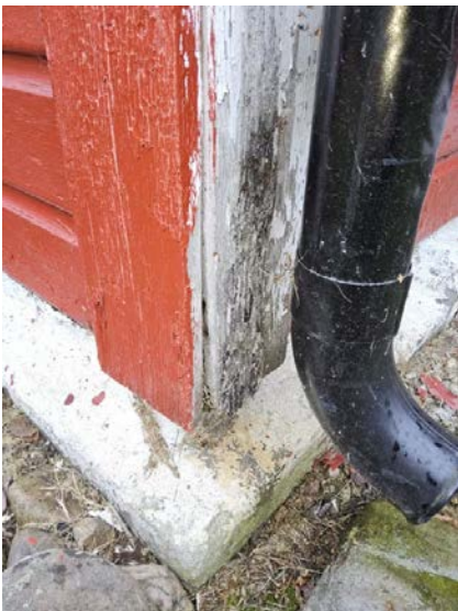
Bilde viser råteskader på fasaden.
