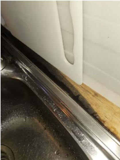
Bilde viser fuktskade rundt oppvaskkum.
