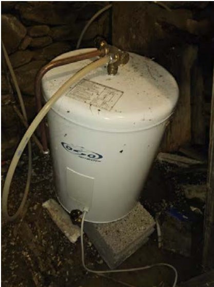
Bilde viser varmtvnsbereder.
