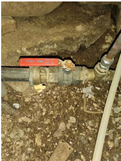
Bilde viser rust på hovedstoppekran.
