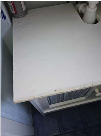
Bilde viser fuktskadet innredning.
