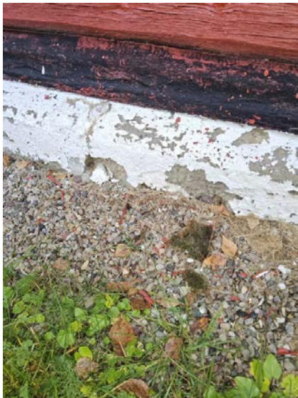
Bilde viser avskalling av grunnmur.
