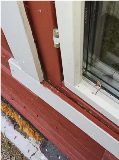
Bilde viser åpninger mellom omramming og vindu.
