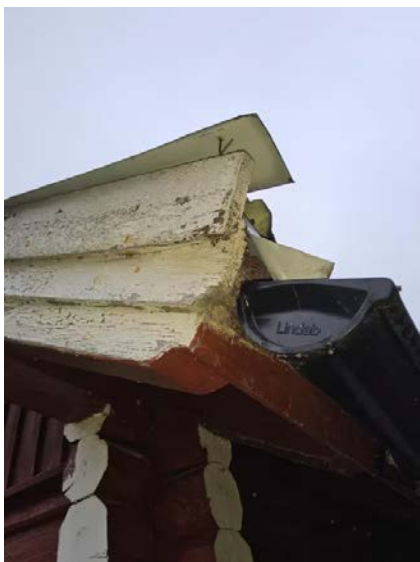
Bilde viser råteskader på fasaden.
