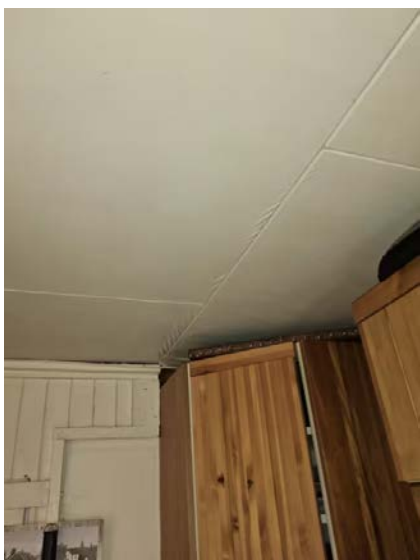
Bilde viser skader i himling.
