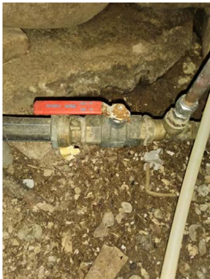
Bilde viser rust på hovedstoppekran.
