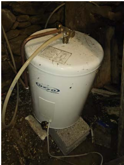
Bilde viser varmtvannsbereder.
