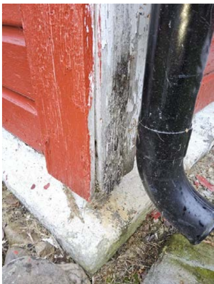
Bilde viser råteskader på fasaden.
