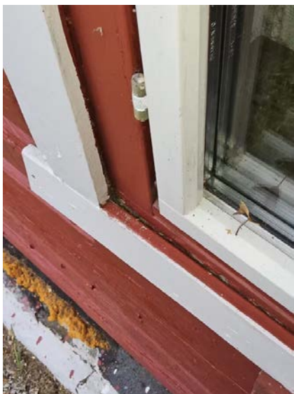
Bilde viser åpninger mellom omramming og vindu.
