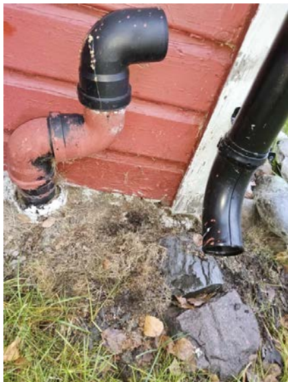
Bildet viser nedløp avsluttet over bakken.
