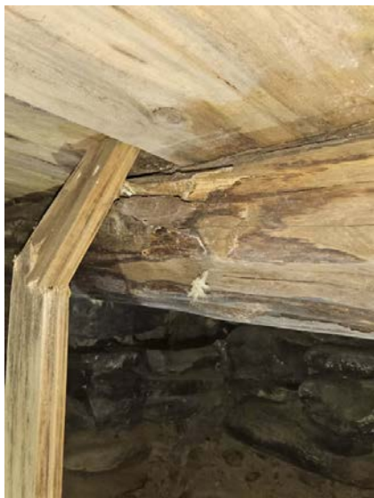
Bilde viser råteskader i etasjeskiller.
