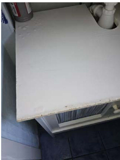
Bilde viser fuktskadet innredning.
