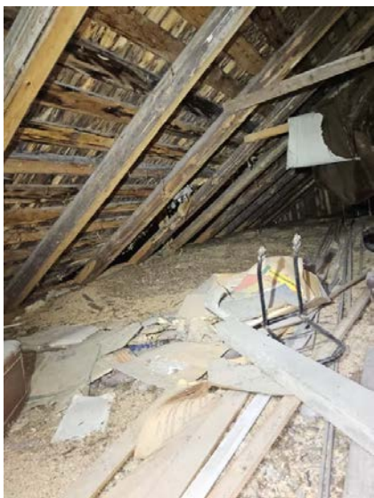
Bilde viser kaldtloft sett fra luke.
