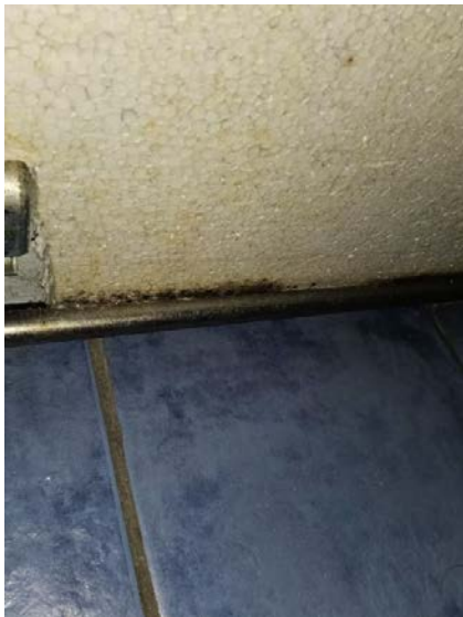
Bilde viser muggsopp på isoporplate på vegg.
