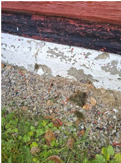
Bilde viser avskalling av grunnmur.
