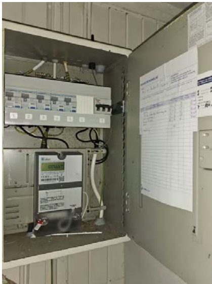
Bilde viser sikringsskap.
