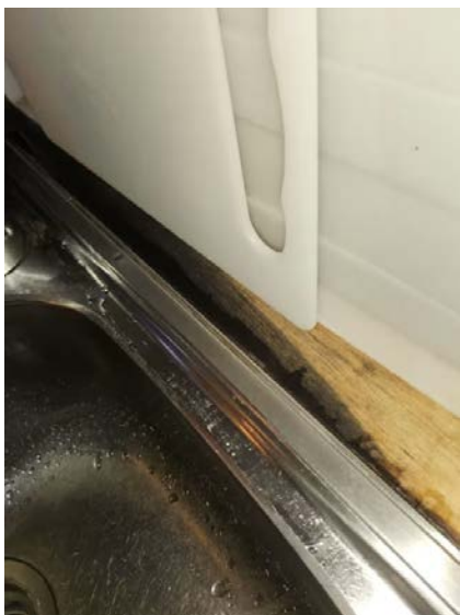
Bilde viser fuktskade rundt oppvaskkum.
