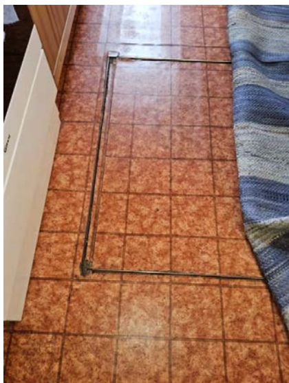
Bilde viser slitt gulv.
