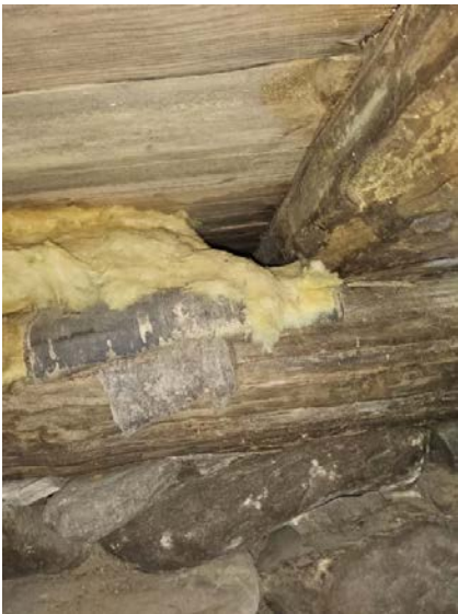
Bilde viser mangelfull og ufagmessig isolering.
