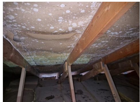
Sopp og muggdannelser på undertak.
