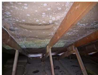
Sopp og muggdannelser på undertak.
