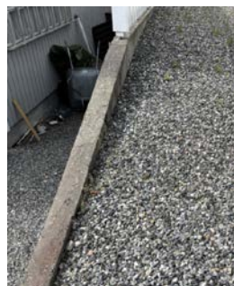
Manglende rekkverk på liten del av støttemur.
