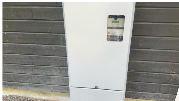
Inntaksskap på yttervegg med strømmåler.
