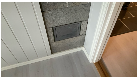
Ildfast plate mangler på gulvet under sotluke
