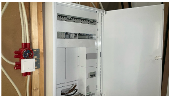
Sikringsskap med automatsikringer er plassert i sportsbod.
