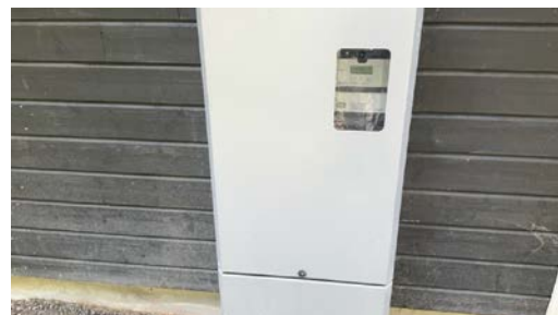
Inntaksskap på yttervegg med strømmåler.
