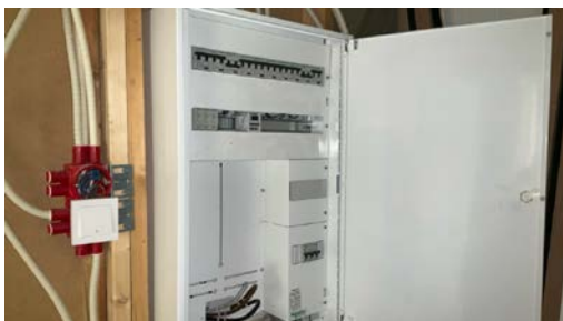
Sikringsskap med automatsikringer er plassert i sportsbod.
