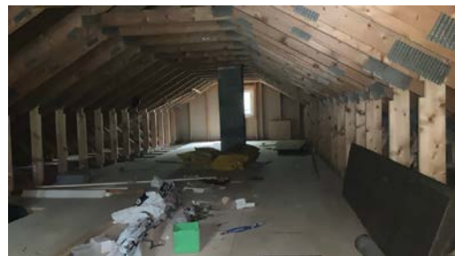
Loftet har begrenset ventilering. Ventilert i raft og gavf anbefales montert.
