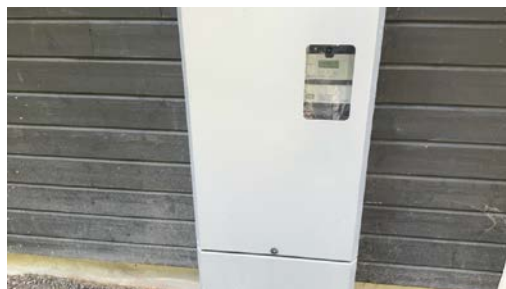
Inntaksskap på yttervegg med strømmåler.
