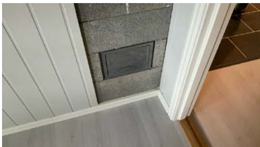
Ildfast plate mangler på gulvet under sotluke
