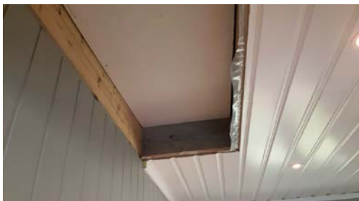
Provisorisk loftsluke. Bør skiftes ut med isolert luke med pakninger.
