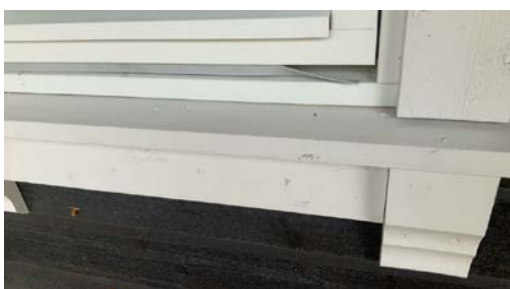
Det er ikke monter beslag over og under vinduer.
