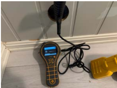
Fuktmåling med pigg mot våtrom: Det ble ikke målt forhøyde fuktverdier ved hulltaking på befaringstidspunktet.
