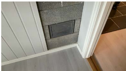
Ildfast plate mangler på gulvet under sotluke
