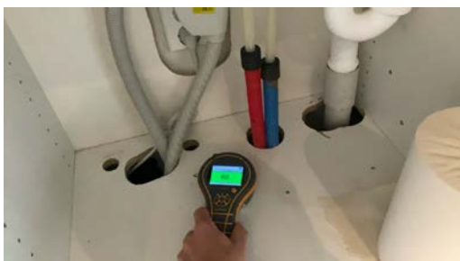
Benkeskap. Ved bruk av fuktindikator på utsatte steder registrerte jeg ingen unormale verdier.
