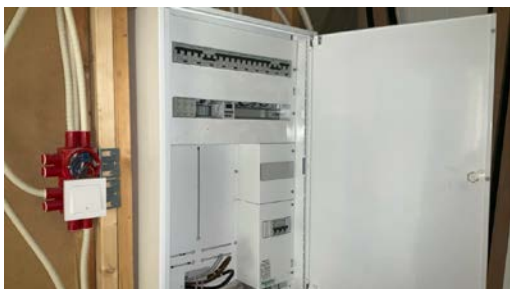
Sikringsskap med automatsikringer er plassert i sportsbod.
