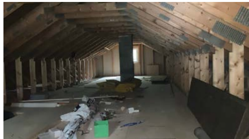
Loftet har begrenset ventilering. Ventilert i raft og gavl anbefales montert.
