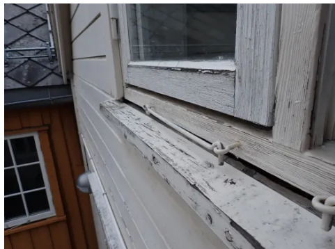
Malingsavflassing og manglende beslag.
