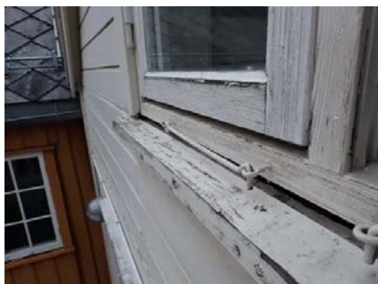
Malingsavflassing og manglende beslag.
