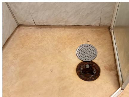
Fuktskader i dusjen.
