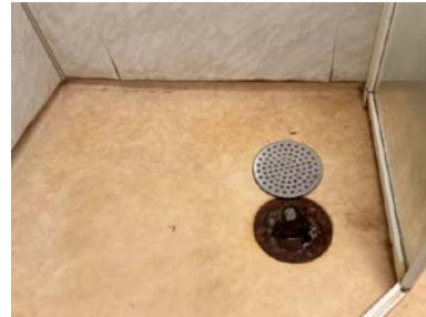
Fuktskader i dusjen.
