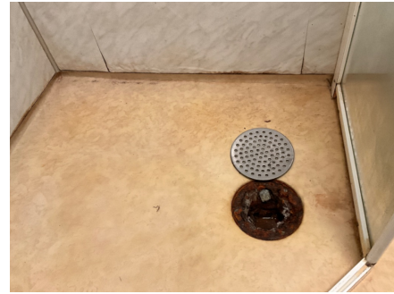
Fuktskader i dusjen.
