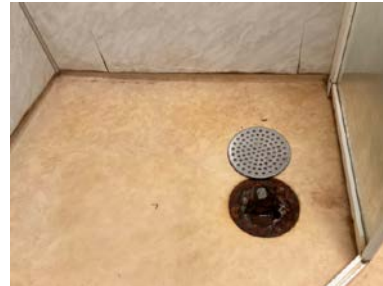
Fuktskader i dusjen.
