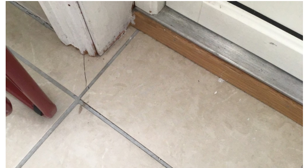
sprekker og bom
