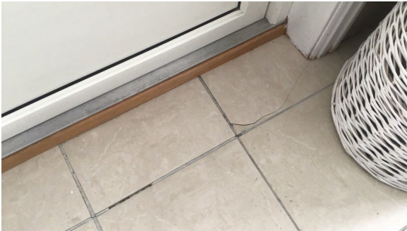
sprekker og bom
