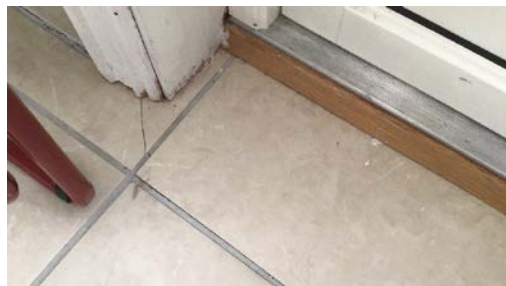
sprekker og bom
