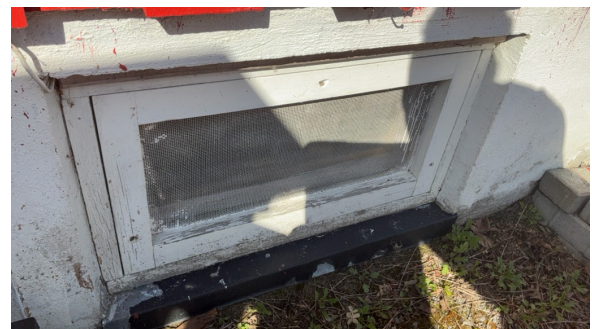
Eksempel på slitasje.
