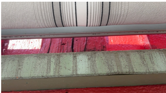
Eksempel på råte i kledning over vindu.
