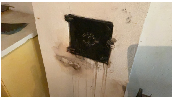
Sotluke i kjeller.
