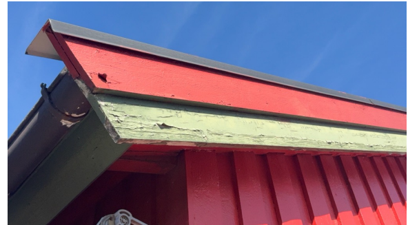
Eksempel på slitasje.
