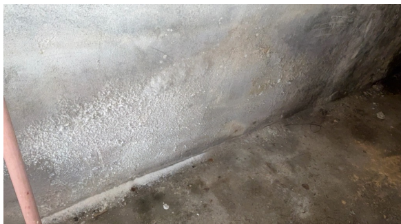
Eksempel på saltutslag
