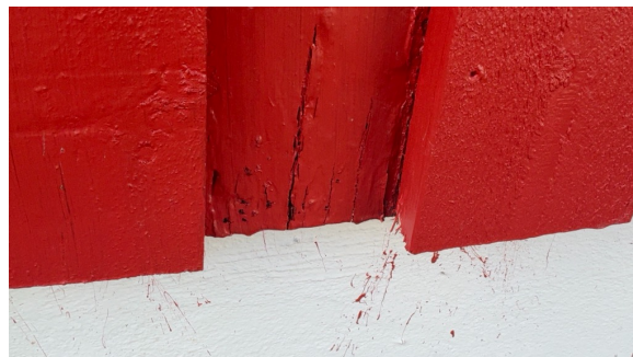
Eksempel på råte i kledning mot garasje.
