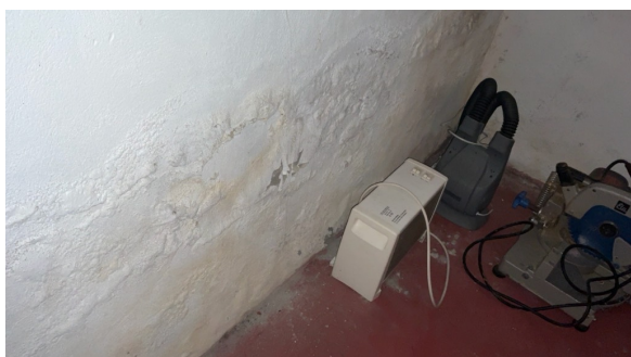
Eksempel på avskaling på vegg
