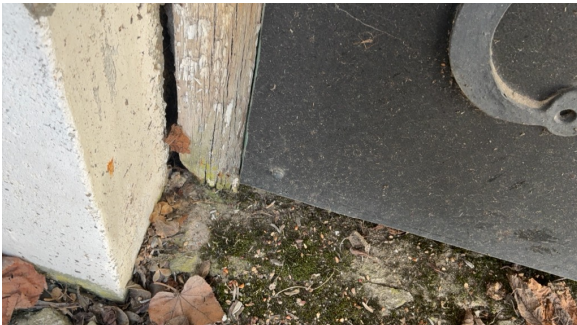
Slitasje på omramming på port.
