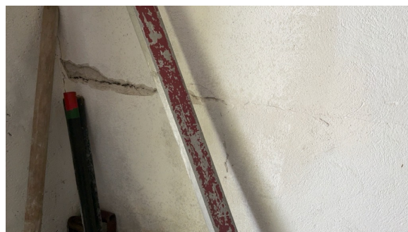
Eksempel på sprekke.
