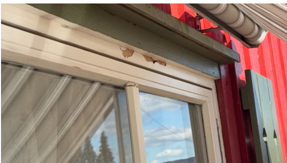
Eksempel på slitasje.
