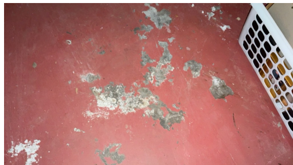
Eksempel på avskaling på gulv.
