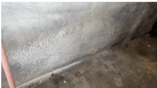
Eksempel på saltutslag
