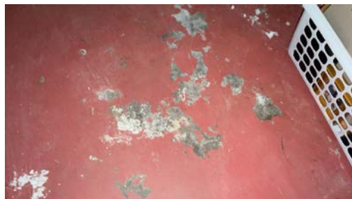
Eksempel på avskaling på gulv.
