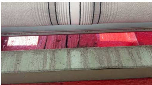
Eksempel på råte i kledning over vindu.
