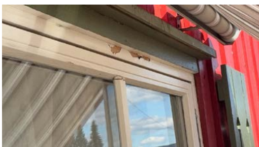
Eksempel på slitasje.
