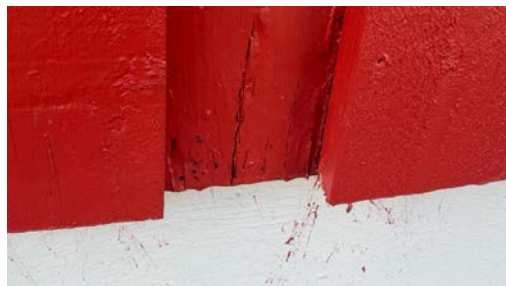
Eksempel på råte i kledning mot garasje.
