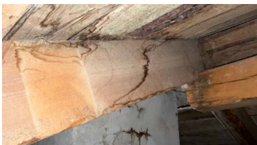
Noen fuktmerker ved pipe.
