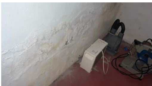
Eksempel på avskaling på vegg
