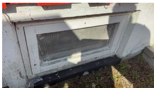
Eksempel på slitasje.
