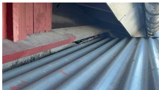
Undertak som er brettet opp på vegg har løsnet.
