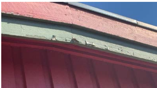
Eksempel på slitasje.
