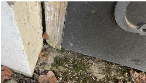
Slitasje på omramming på port.
